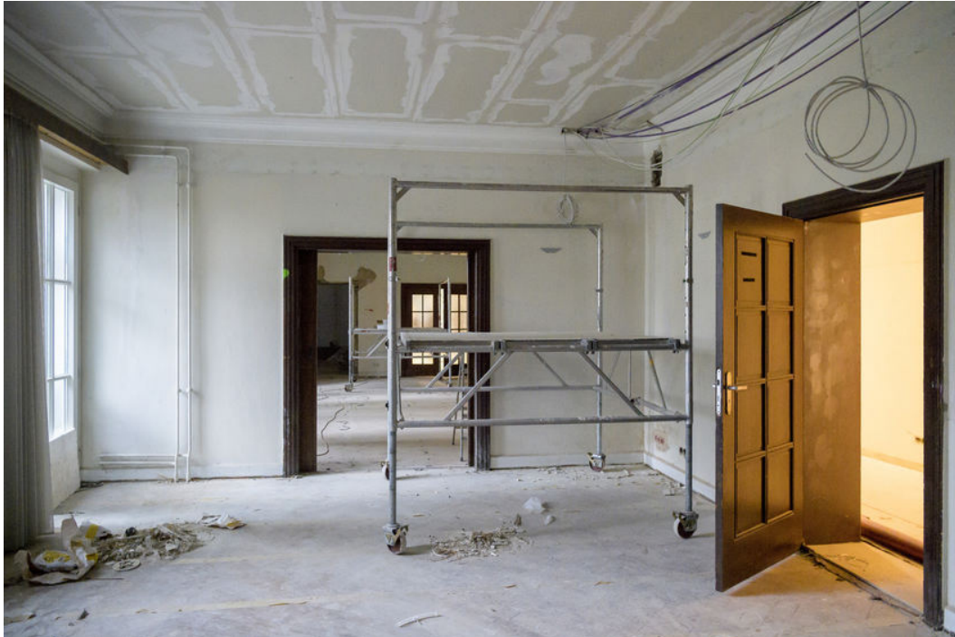
Vor Jahrzehnten verwendete, zum Teil asbesthaltige Baustoffe müssen entfernt werden. © Philipp Rothe
