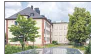
Am H-Gebäude wurden falsche Fenster angebracht. Bald kommen aber echte hinzu.
